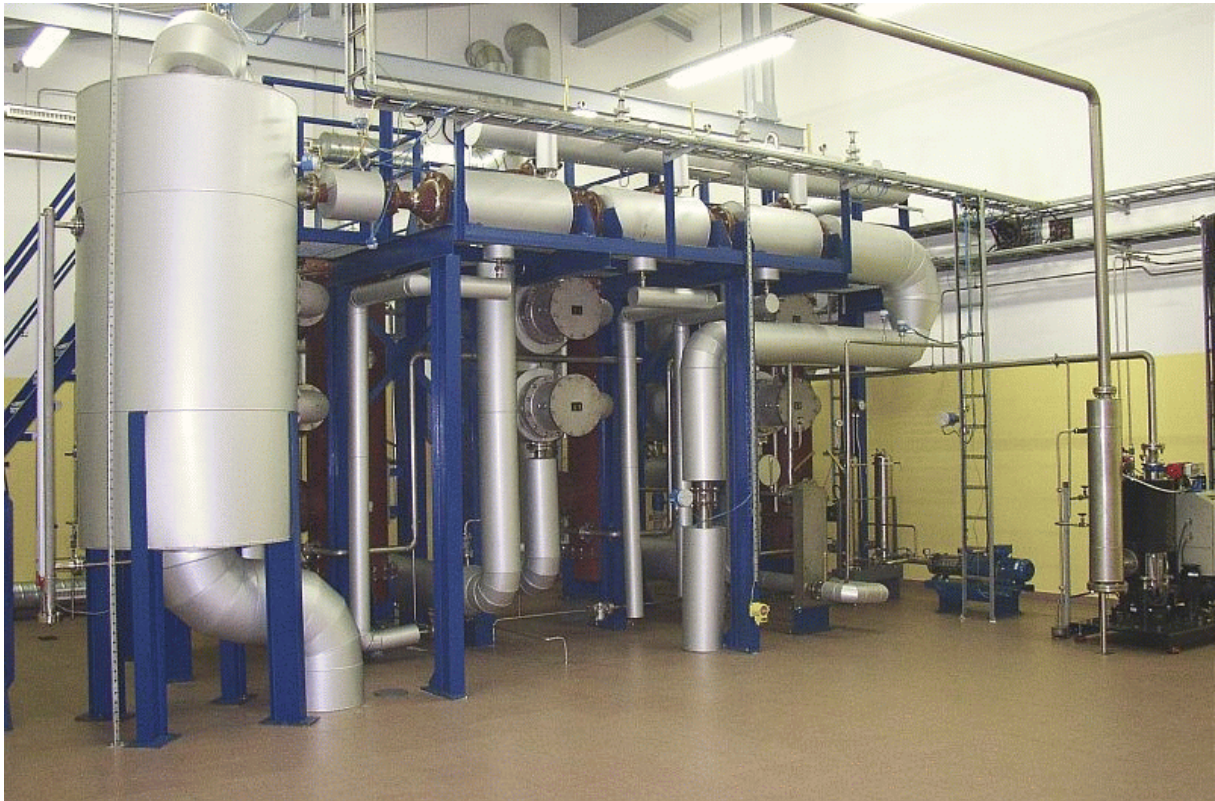
Abb. 29 Dämpfepermeationsanlage zur Äthanolentwässerung
